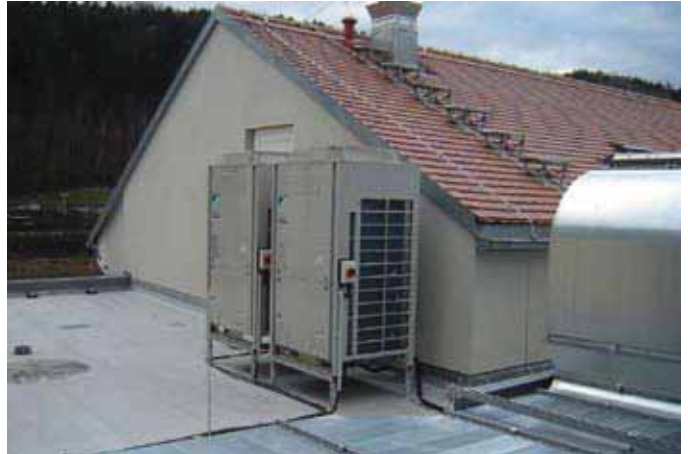
Bild 8: Zimmerkühlung auf der Südseite: Aufstellung der Außengeräte auf einem Flachdach
