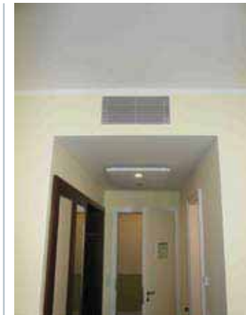
Bild 9: Zimmerkühlung auf der Südseite: Abluft im Deckensegel über dem Eingang, Zuluft über das Lüftungsgitter
