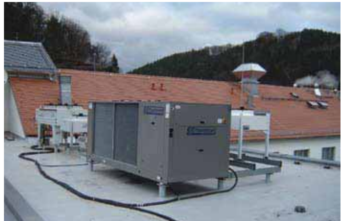
Bild 10: Flachdachaufstellung des Kaltwassersatzes der Gebäudekühlung sowie der Rückkühlung der Gewerbekälte (links) und der Notrückkühlung des BHKW (rechts)
