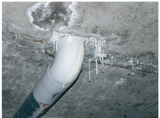
Bild 3. Ausblühungen und Aussinterungen durch Feuchtigkeitseinfluss
