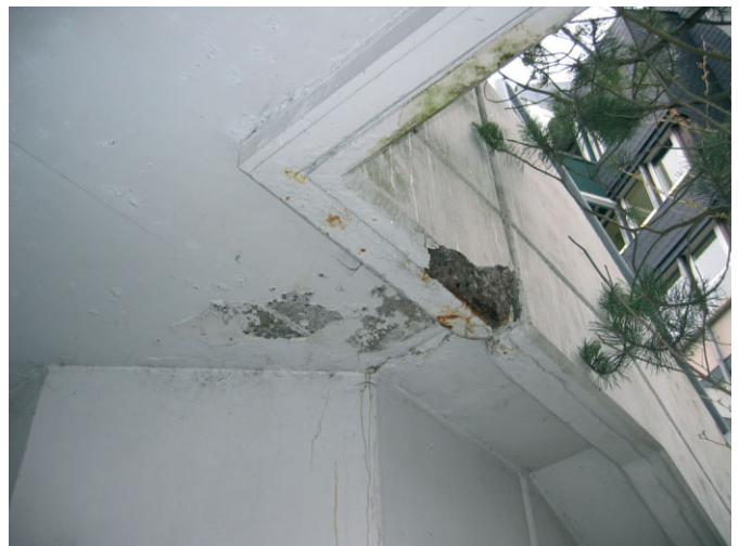
Bild 2. Abplatzungen der Oberflächenbeschichtung und der Betondeckung
