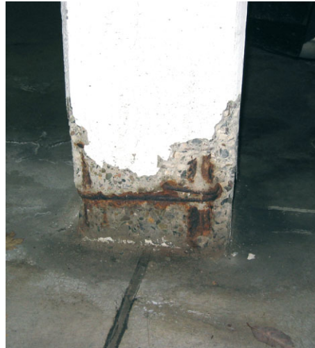
Bild 4. Korrosionsschädigung der Bewehrung (Fotos: bow ingenieure)
