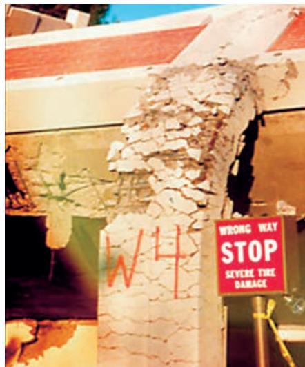
Abb. 12: Brückenpfeiler nach starkem Erdbeben
