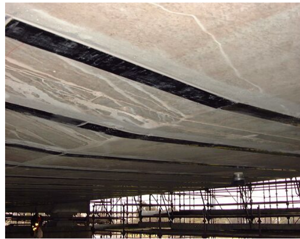
Bild 16 Verstärkte Bodenplatte (Untersicht)
